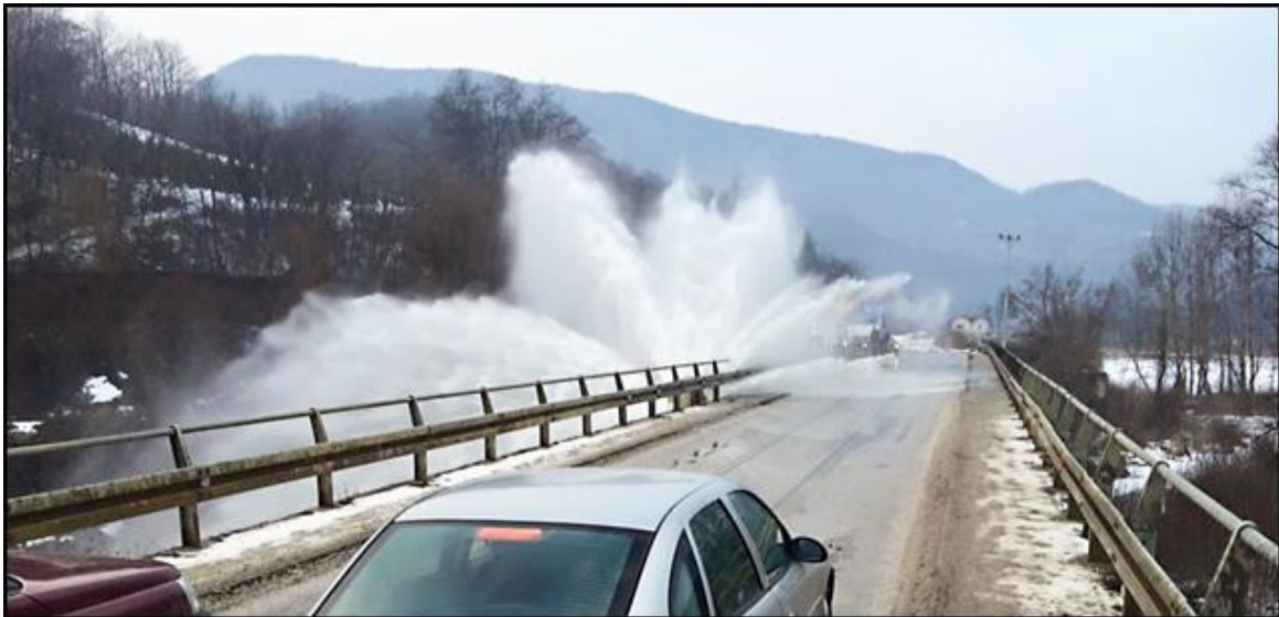
Слика 11. Хаварија на краку за Лучане магистралног ценовода водосистема „Рзав“ – мост преко Западне Мораве код Кратовске стене (25.01. 2016)
