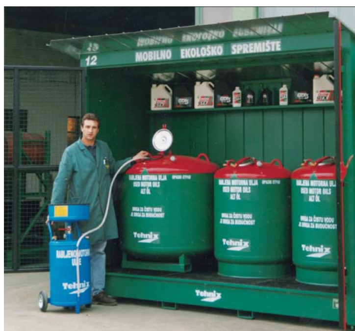
Слика 34 - Пример складиштења отпадног уља
