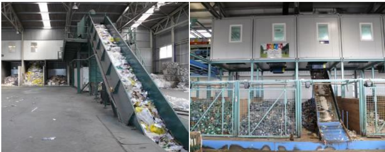
Slika 4.2. Izgled postrojenja za separaciju otpada
