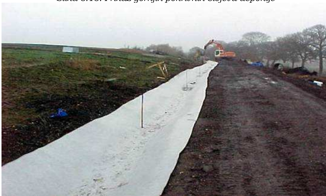
Slika 5.14. Prikaz deponije sa obodnim kanalima za oticanje vode sa folije
