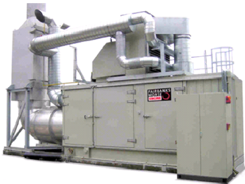
Slika 6.9 Izgled postrojenja za kombinovanu proizvodnju električne i toplotne energije
