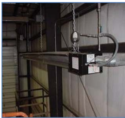
Слика 4.22 Инфрацрвено грејање просторија
