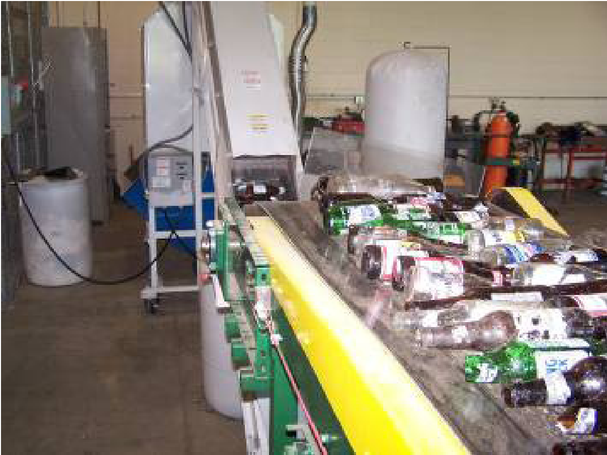
Слика 5.7 Постројење за рециклажу стакла
